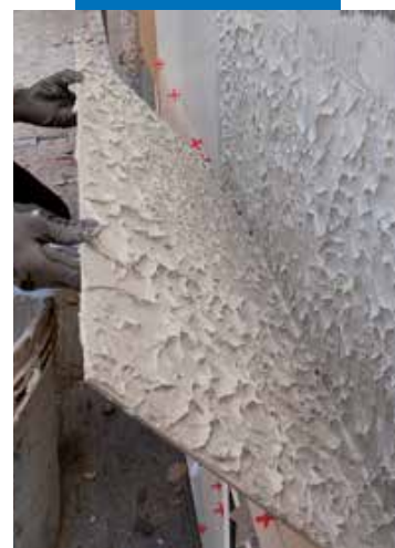
Kontroll av att plattans baksida är helt täckt vid montering på en utvändig fasad
