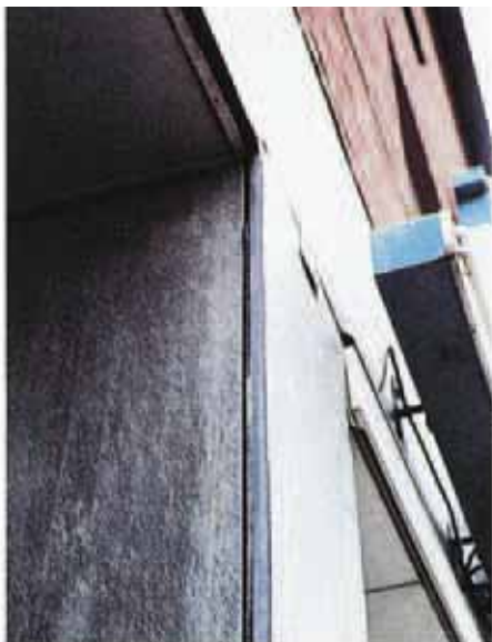
93. Beklädnad som utsätts för belastning från ovanliggande material trycks ut.
