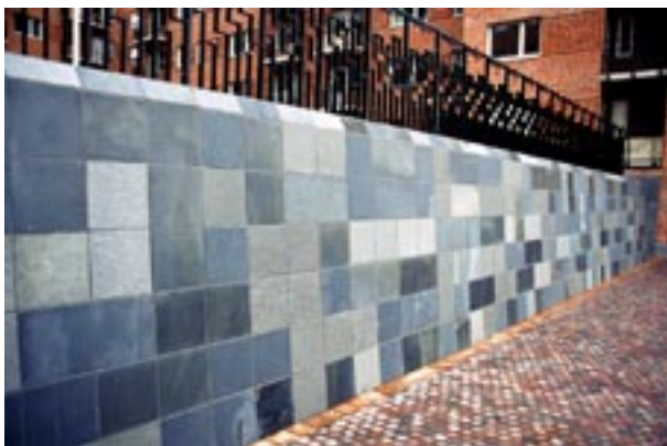
Fig 8.16 Beklädnadsmur. Skiffer med olika ytbehandlingar, klovyta, slipad och polerad. Kvadratiska plattor i ruttmönster.
