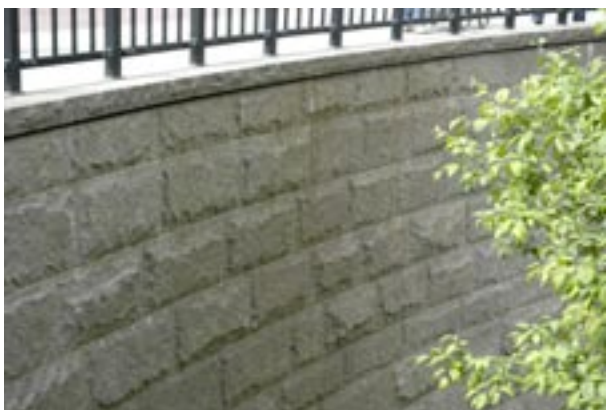
Fig 8.12 Svängd beklädnadsmur av grå granit med råkopp. Kvaderförband. Avtäckning av råkilad granit.
