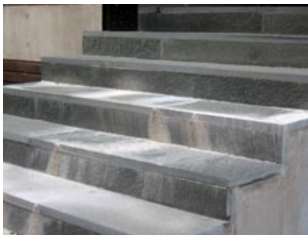
Fig 7.32 Misspyrdande salt- och kalkutfällningar, som är svåra att avlägsna. Sådana bildas när stora mängder vatten transporteras genom cementbruk.
