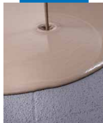
Applicering av Uniplan Eco självutjämnande avjämningsmassa över torr Eco Prim Grip Plus på gammalt golv
