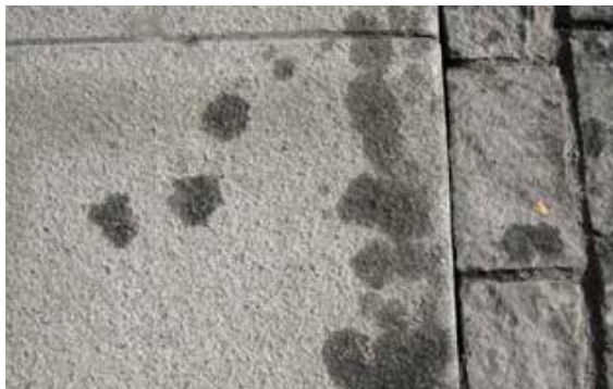
Fig 11.4 Misspdydande oljefläckar på granitramsten.
