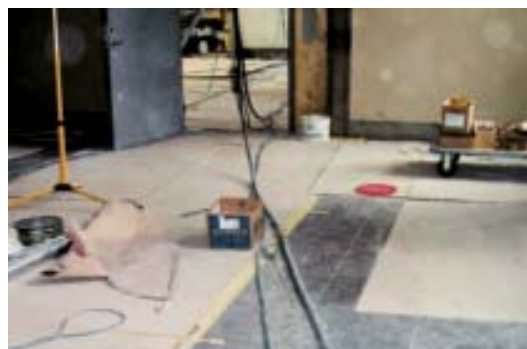
Fig 4.56 Avskräckande exempel där skyddstäckningen är utförd så att den inte klarar av att skydda golvet från aktuella belastningar.
