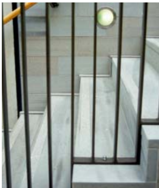
Fig 5.36 Frästa spår i stegens framkanter ger halkskydd och visuell markering.
