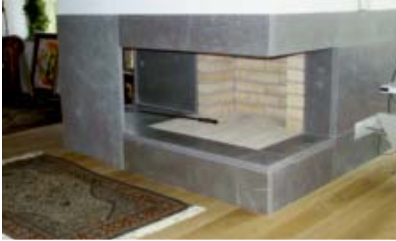
Fig 9.2 Inbyggd spis beklädd med kalksten. I själva eldhärden ligger eldfast tegel. Eldhärden är så djup att gnistskydd inte krävs på parkettgolvet.
